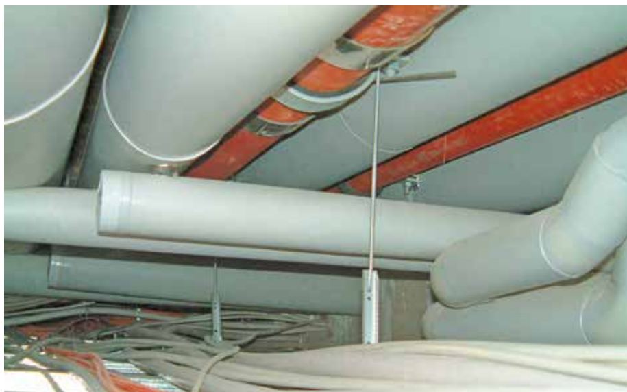
Abbildung 1: Zwischendeckenbereich mit hoher Installationsdichte und geringen Abständen zur Unterdecke Foto: Hilti Deutschland AG
